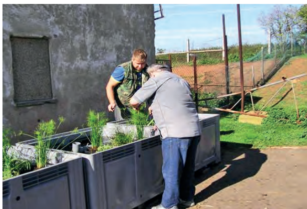
Obr. 27. Instalace kontejnerového systému pro sledování degradace léčiv (foto T. Vaněk)
